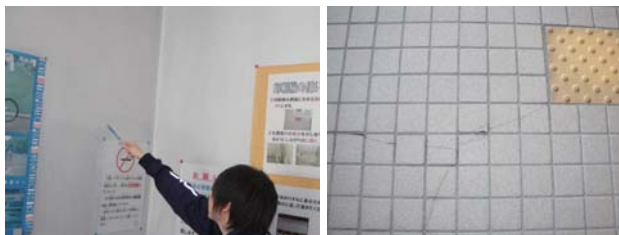
点検の様子 床のヒビ、チェックの写真
